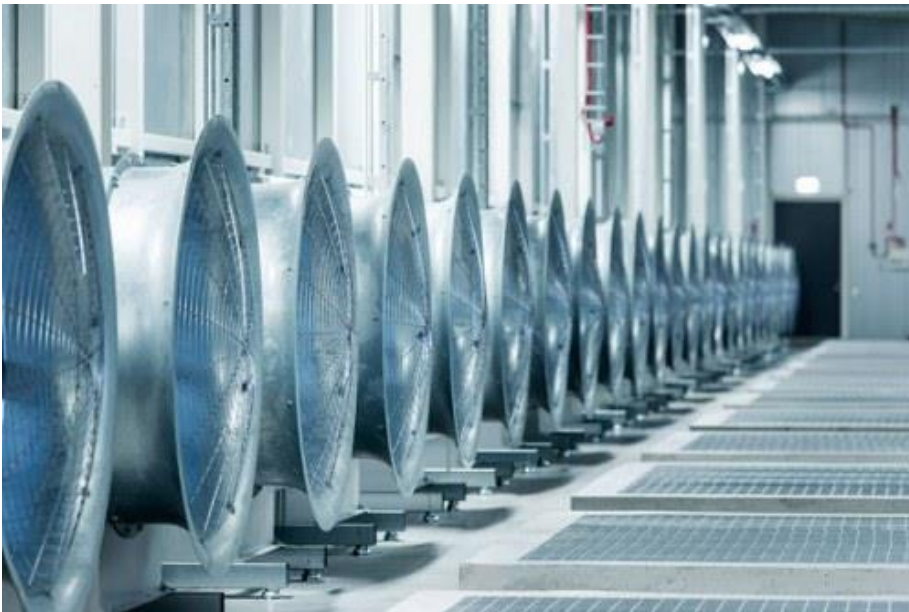
Şekil 2. Veri merkezinde iklimlendirme sistemi
